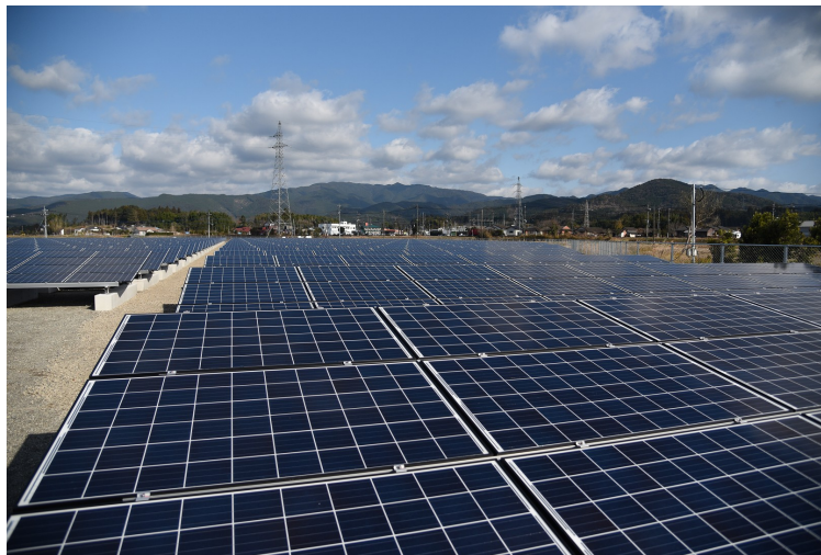
<ハヤシソーラーシステム高柳発電所>
