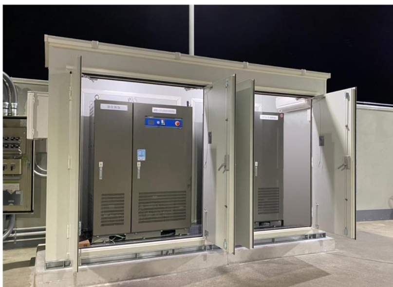
<納入されたリチウムイオン蓄電システム YRW >
