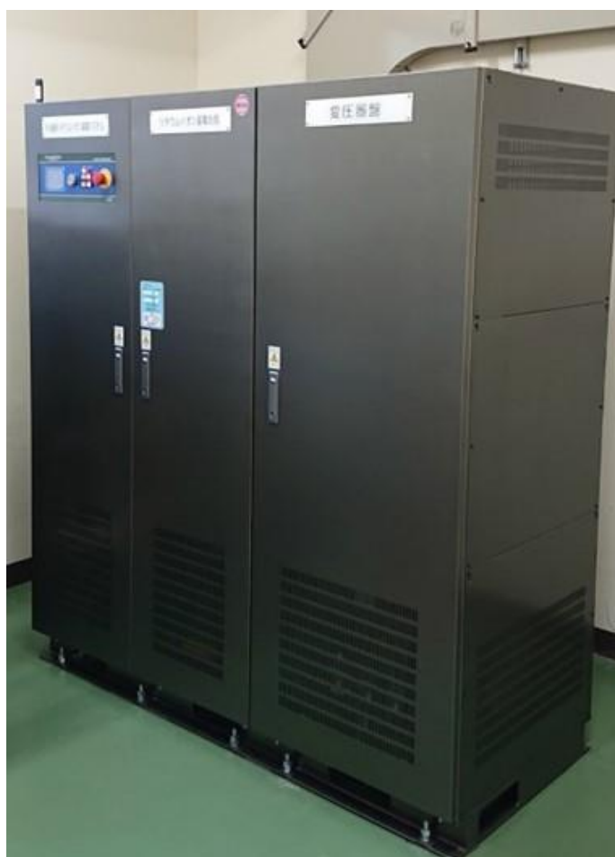
<薦原小学校に納入したリチウムイオン蓄電システム>
