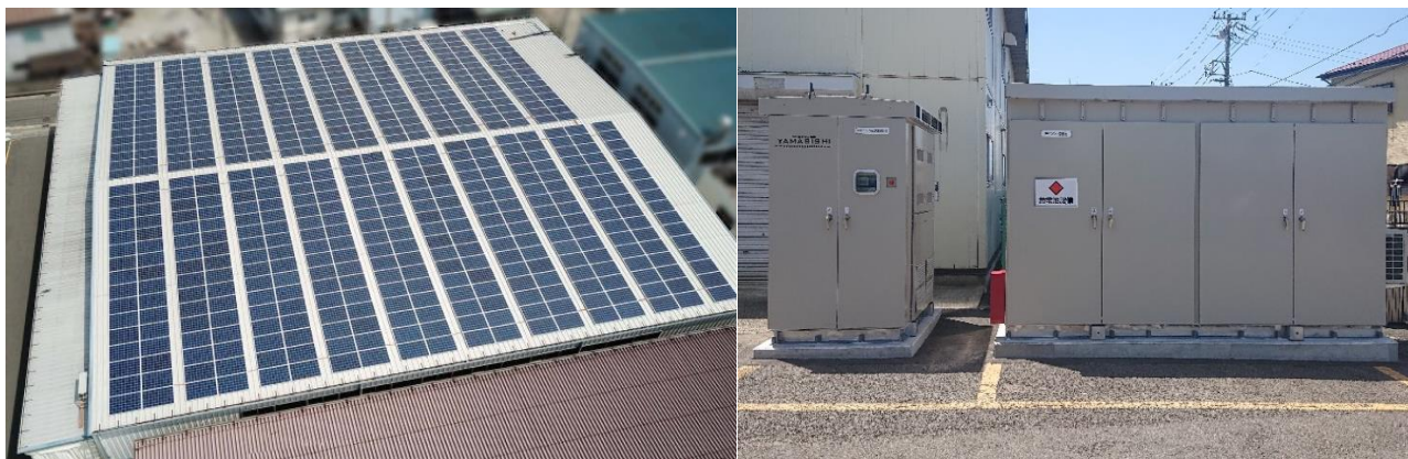
＜海老名工場に設置されている太陽光パネルと自家消費システム＞
