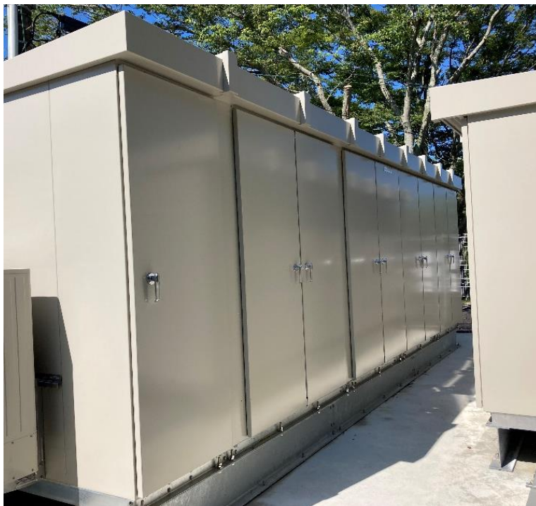
&lt;いすみ市大原中学校に納入したリチウムイオン蓄電システム&gt;
