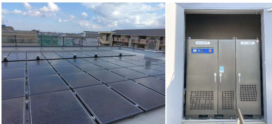
< 「大志寮」に設置された太陽光発電設備(左)と産業用蓄電システム(右) >
