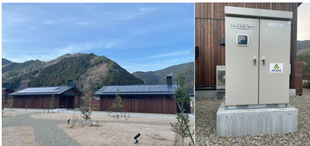
<西粟倉村「100年の森ホテル」に設置された太陽光パネルと蓄電システム>
