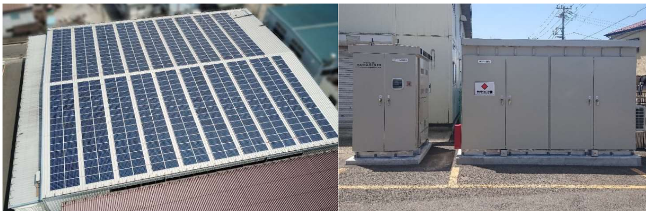
<海老名工場に設置されている太陽光発電とリチウムイオン蓄電システム>
